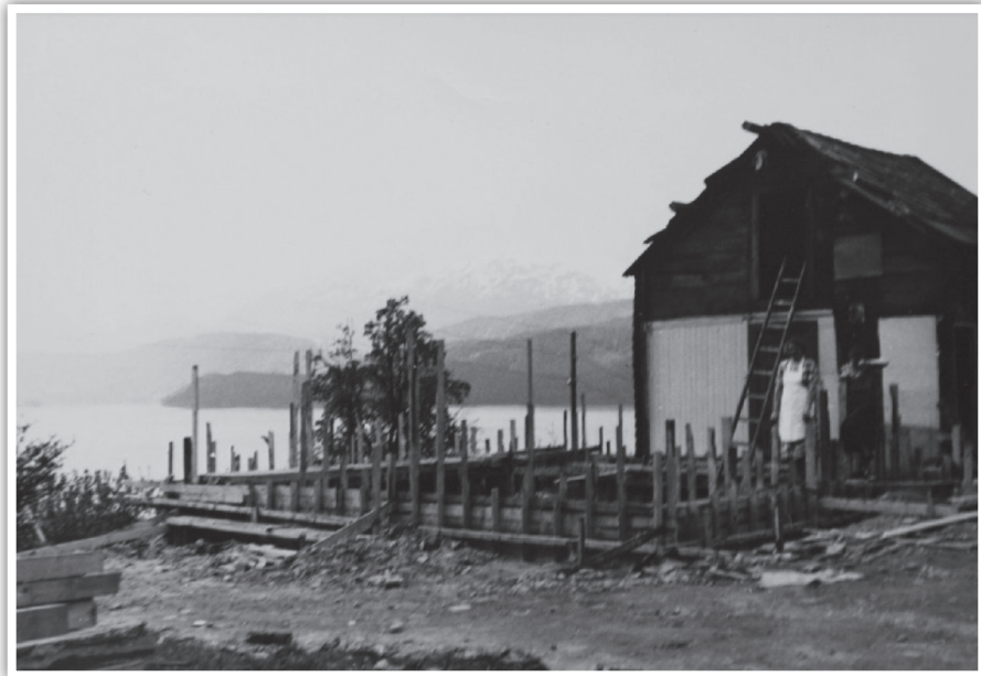
Solveig og Ole, sommar 1958. Det var nok ikkje så lett å bu midt oppi byggjeprojektet.
